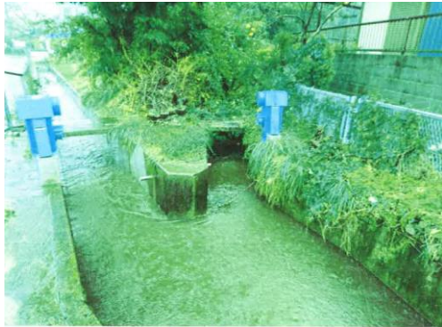
小溝用水:11日に河川課に堰を閉めるように依頼したが閉じられなかった。(2019.10.12 10:32)
